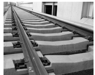
実際に施工された防振型鉄道軌道
